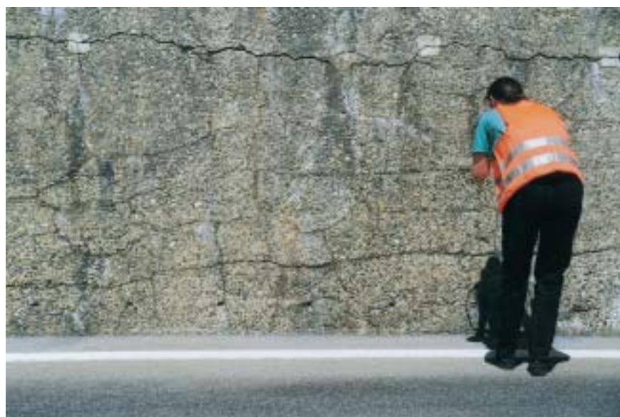
Abb. 3 AAR-Schäden in unbewehrter Stützmauer.
